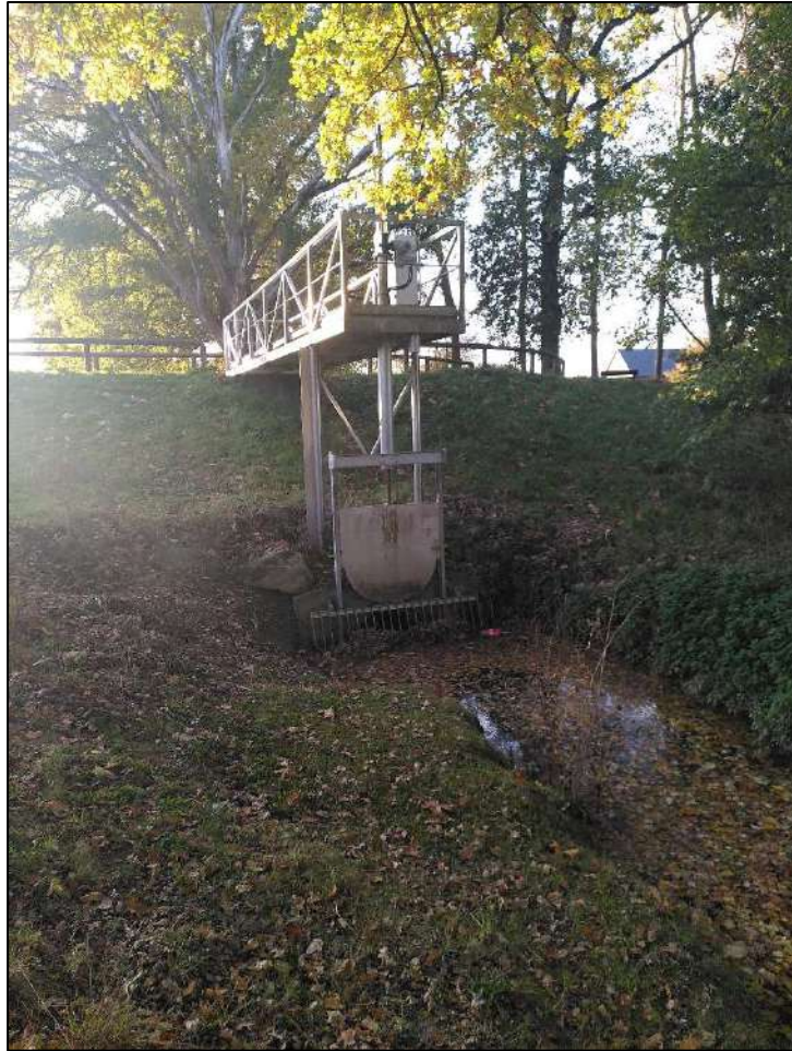
Photo 102: vue de l'ouvrage permettant une régulation des débits et l'arrêt des pollutions - IAO SENN - 2021
